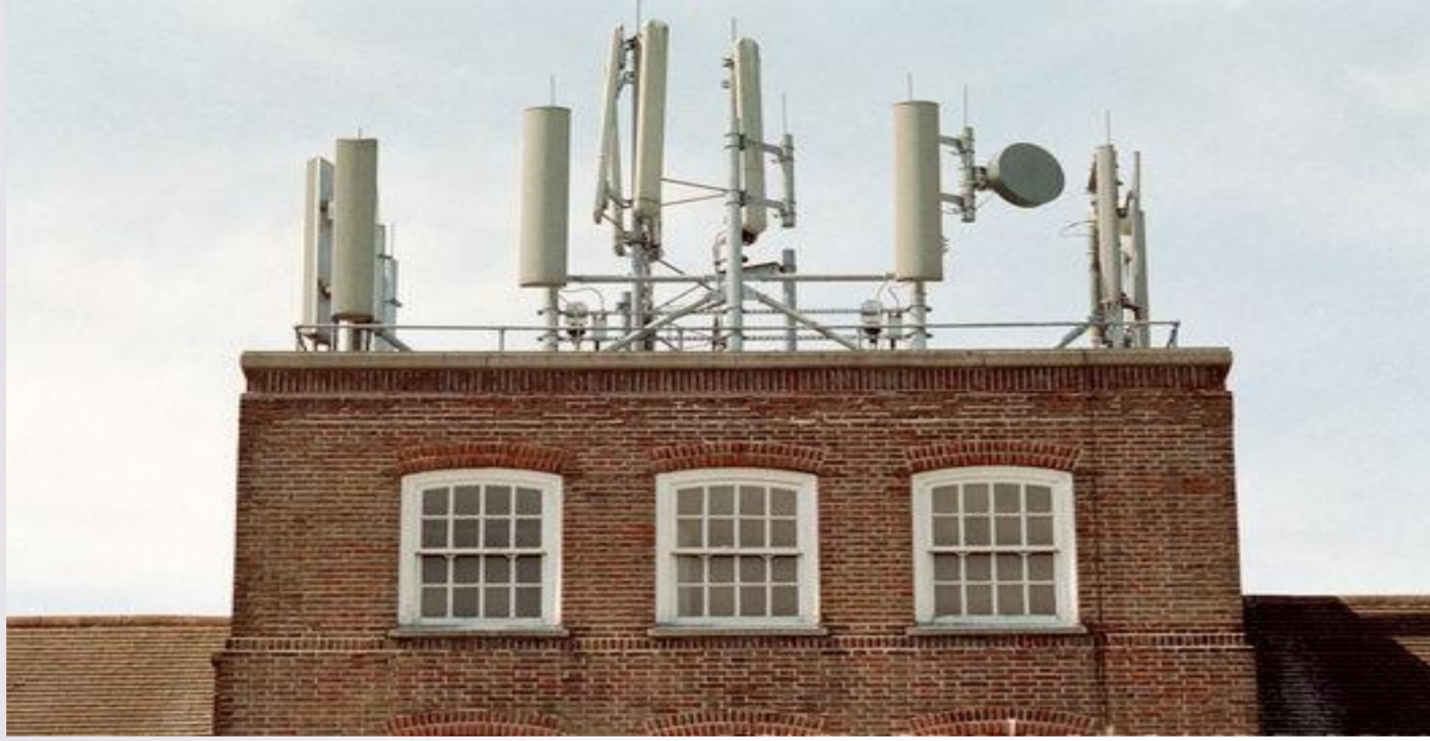
Resim 1. Çatısına Baz istasyonu kurulmuş olan bir yapı
